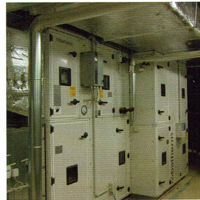
Figure 7: Les armoires de traitement de l'air dans la cave, avec un débit nominal de 15.660 m 3 /h pour les classes et de 9.000 m 3 /h pour le réfectoire. Pour un débit maximal, le refroidissement adiabatique fournit une capacité de respectivement 156 et 90 kW.
