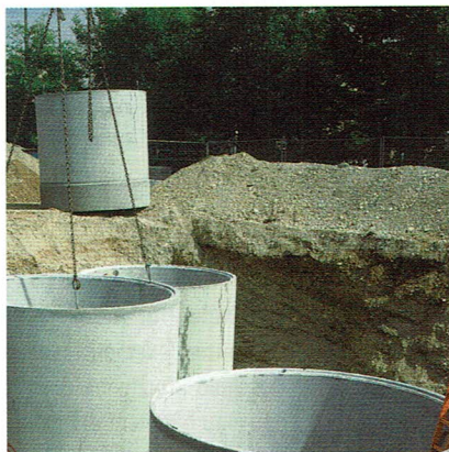
Figure 6: Le réservoir d'eau de pluie a une contenance de 48 m 3 ; il est relié à 1.800 m 2 de toiture verte.
