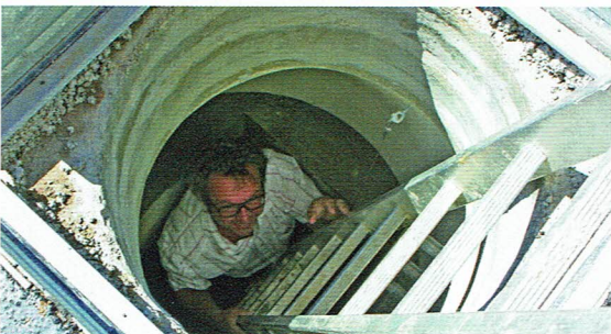
Figure 9: Placement d'un système de stockage d'eau de pluie. L'installation comprend une gaine filtrante et quatre réservoirs en béton d'une contenance totale de 36 m 3 . Il y a également une installation de relevage avec deux pompes immergées pour un débit total de 16,5 m 3 /h.
