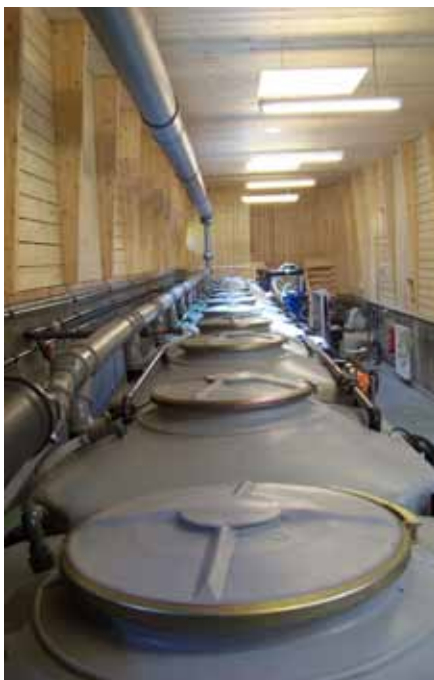
Wirbelbett-Anlage für Grauwasser.
