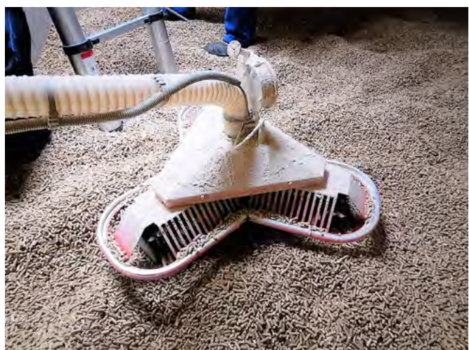
▲ Bild 6 • Entnahmesystem „Maulwurf“, vom Team des Speicherherstellers einschließlich Steuergerät geliefert, montiert und in Betrieb genommen. Bei Brennstoffbedarf geht der elektrische Impuls des Kessels gleichzeitig an Saugturbine und Entnahmesystem. Bild: Mall
