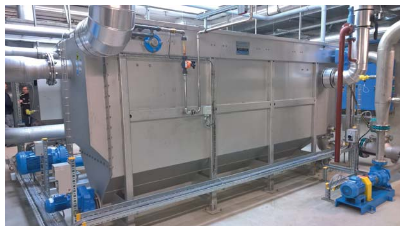
Bild 3: In der Heizzentrale stehen zwei baugleiche Wärmetauscher. Bei Spitzenbedarf sind sie gleichzeitig in Betrieb, sonst abwechselnd. Das Kalte Nahwärmenetz nimmt hier etwa zwei bis vier Kelvin Energie auf und versorgt damit die Wärmepumpen der Gebäude. © Huber
